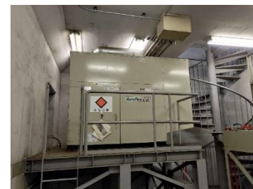
非常用電源設備
