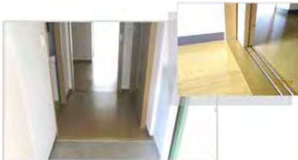
玄関の上がり框は必要最小限の段差 居室内はできる限り段差を解消
