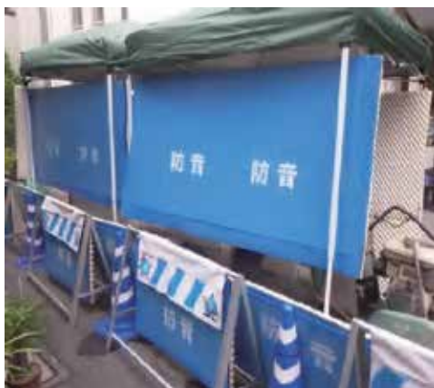
防音パネルによる騒音対策
