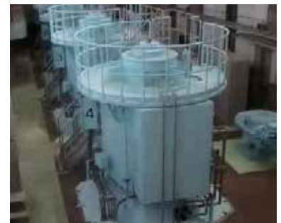
省エネ型ポンプ設備 (上井草給水所)
