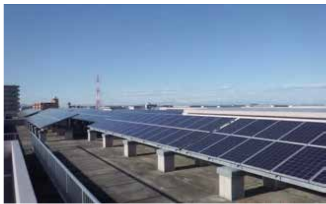
建屋屋上部の太陽光発電設備（朝霞浄水場）
