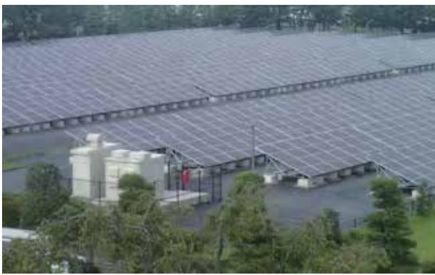
配水池上部の太陽光発電設備（東村山浄水場）
