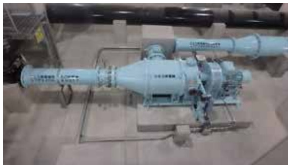
小水力発電設備（江北給水所）
