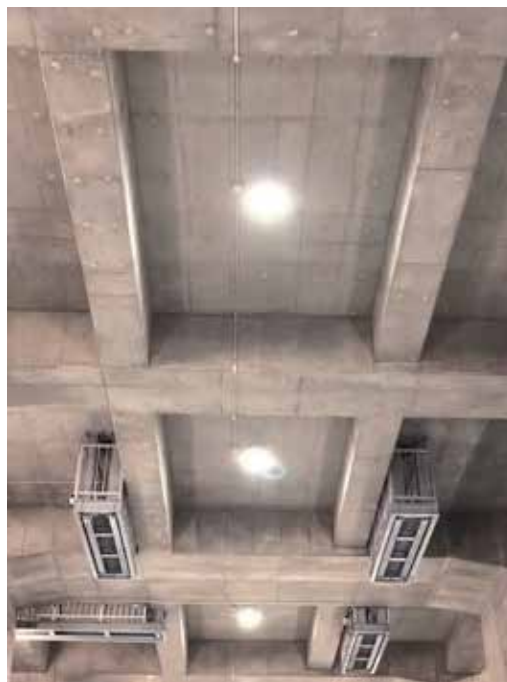
LED 照明の例（金町浄水場）
