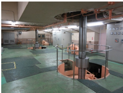
多摩川第一発電所
