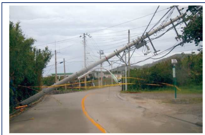
図IV-9 新島若郷地区の被害状況（令和元年9月）
