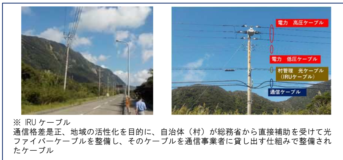
図IV-14 IRU ケーブルが添架されている島しょ地域の都道の状況
