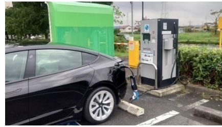
急速充電器を設置した駐車場（舎人公園駐車場）
