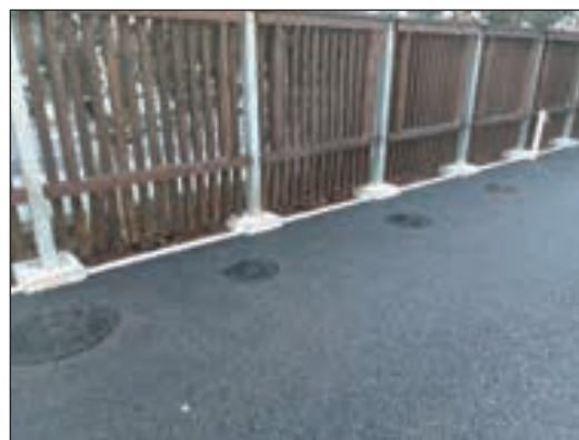
【都立特別支援学校に設置されているマンホールトイレの例】
