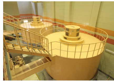
多摩川第三発電所
