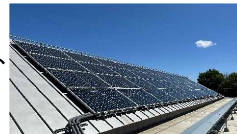
都立学校屋上の太陽光発電設備
