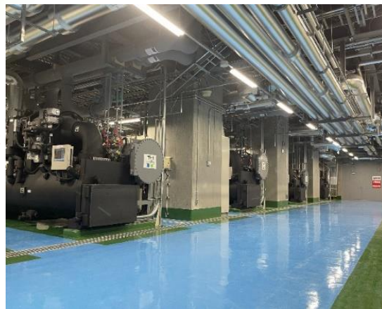
熱供給プラント
