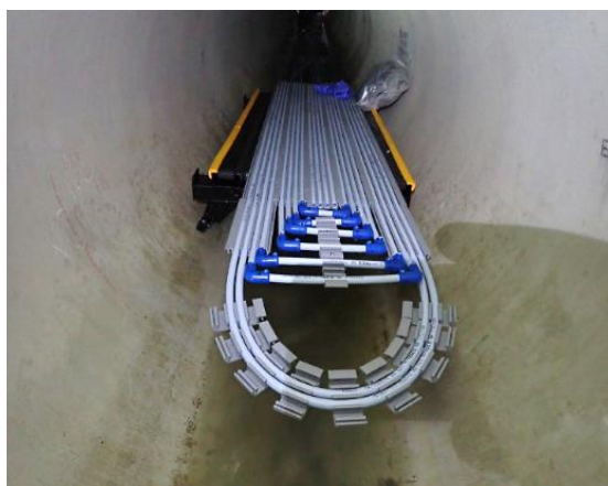
下水道管内に設置した熱交換器
